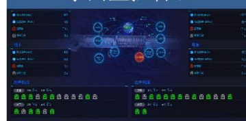
水闸监控管理
